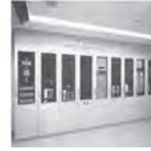
分電盤、制御盤
